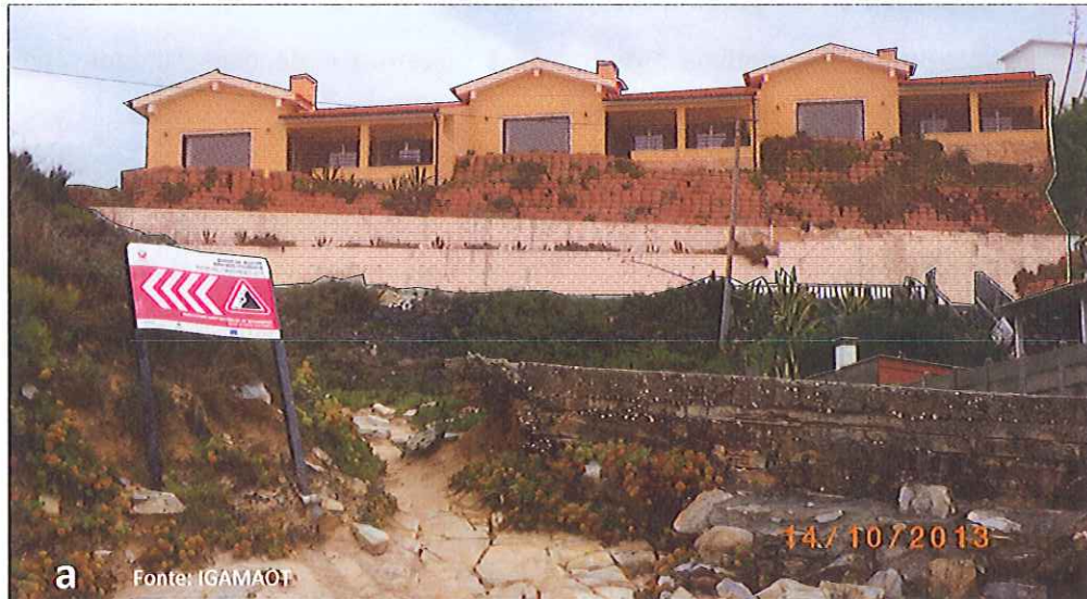
Figura 10 – Fotografias relativas à situação n.º 1, vista de oeste [a] e aéreas de noroeste [b] e sudeste [c]
